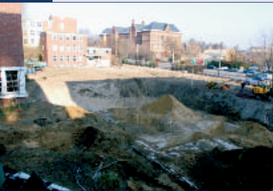
Baugrube im November 2003 vor dem neuen Zugang zur Zentralen Notaufnahme im Haus 60 nach dem Abriss des Hauses 11 (frühere chirurgische Rettungsstelle)
